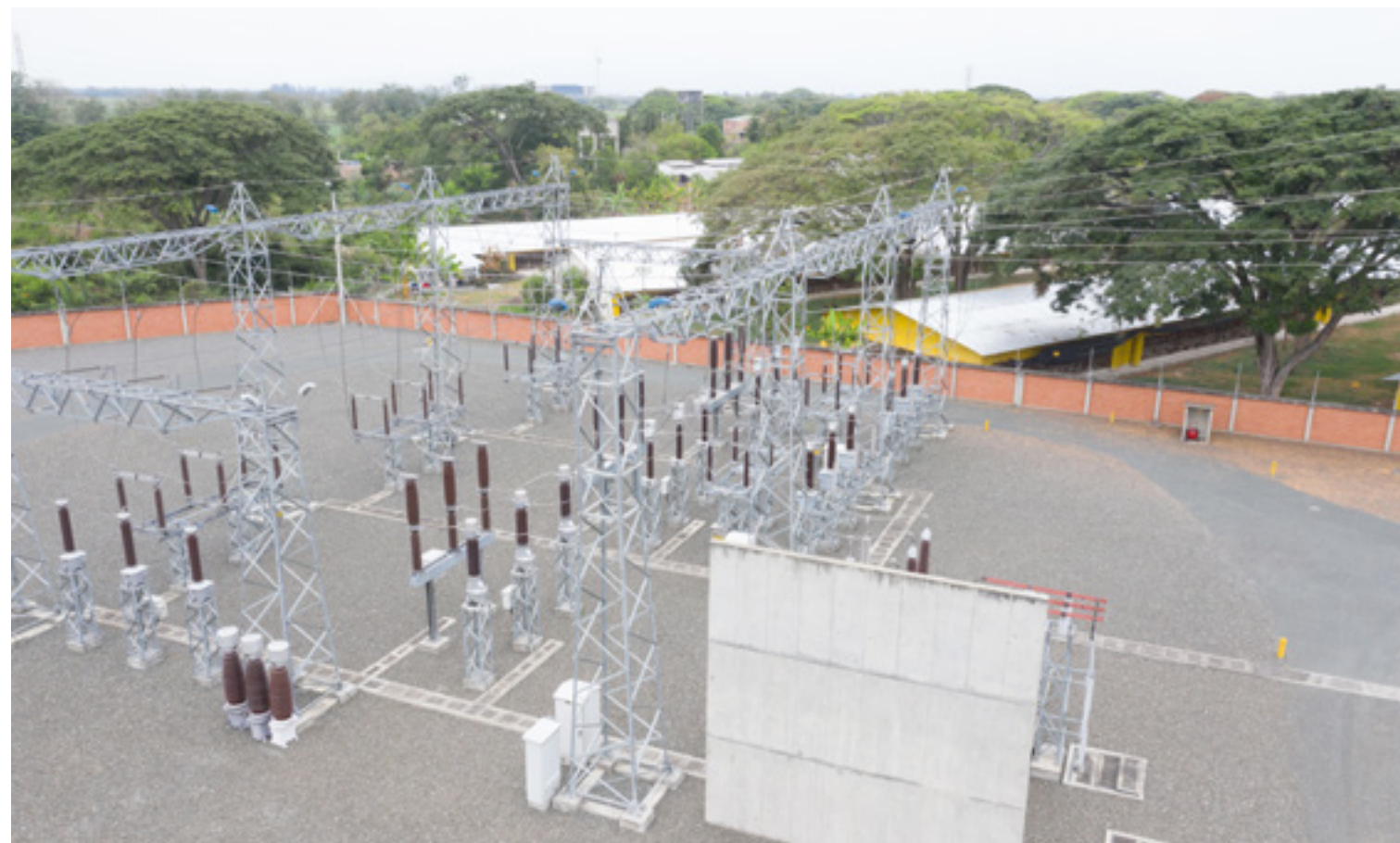
Subestación Palmaseca. Valle del Cauca.
