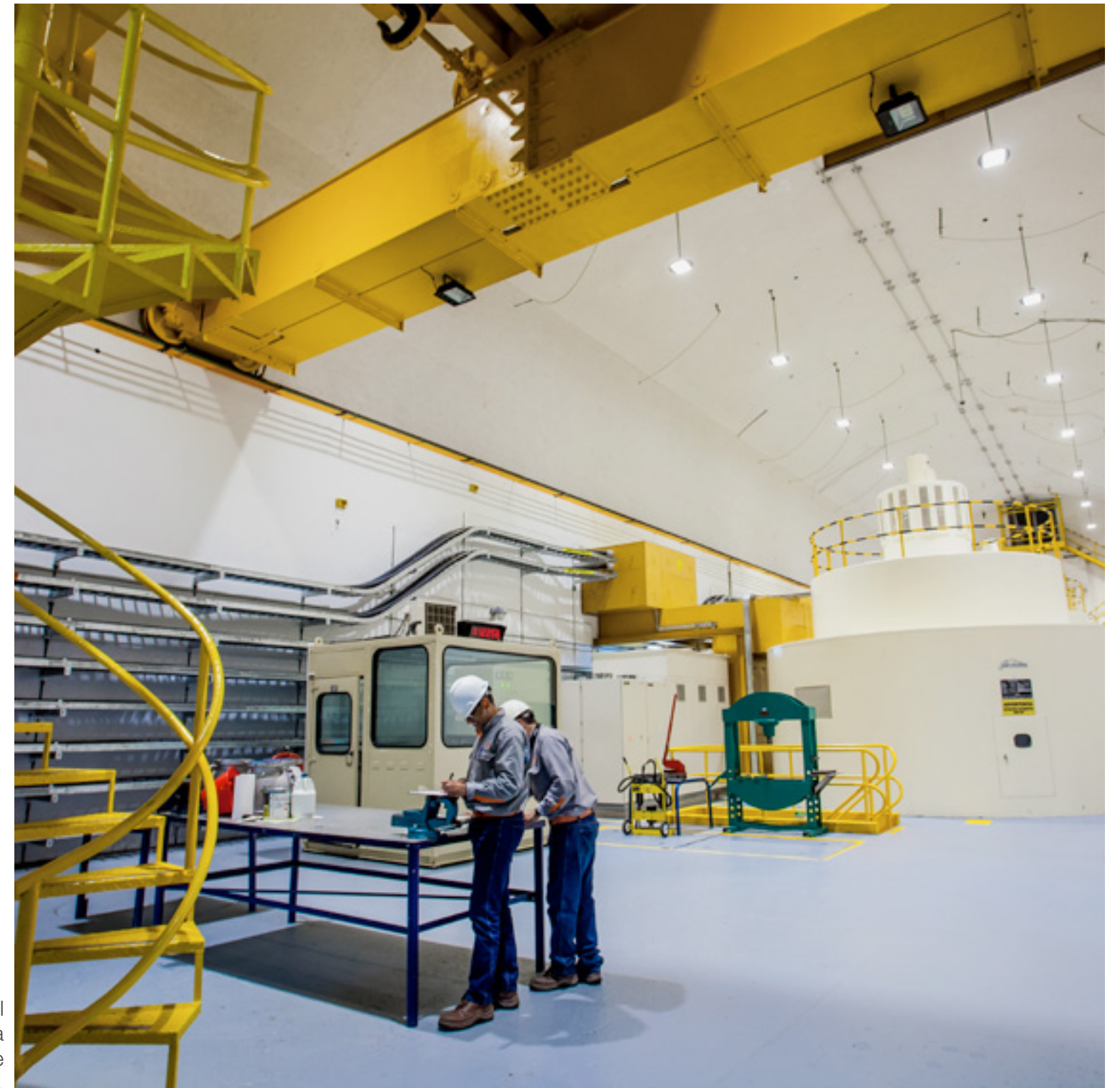
Central hidroeléctrica Calima. Valle del Cauca.
