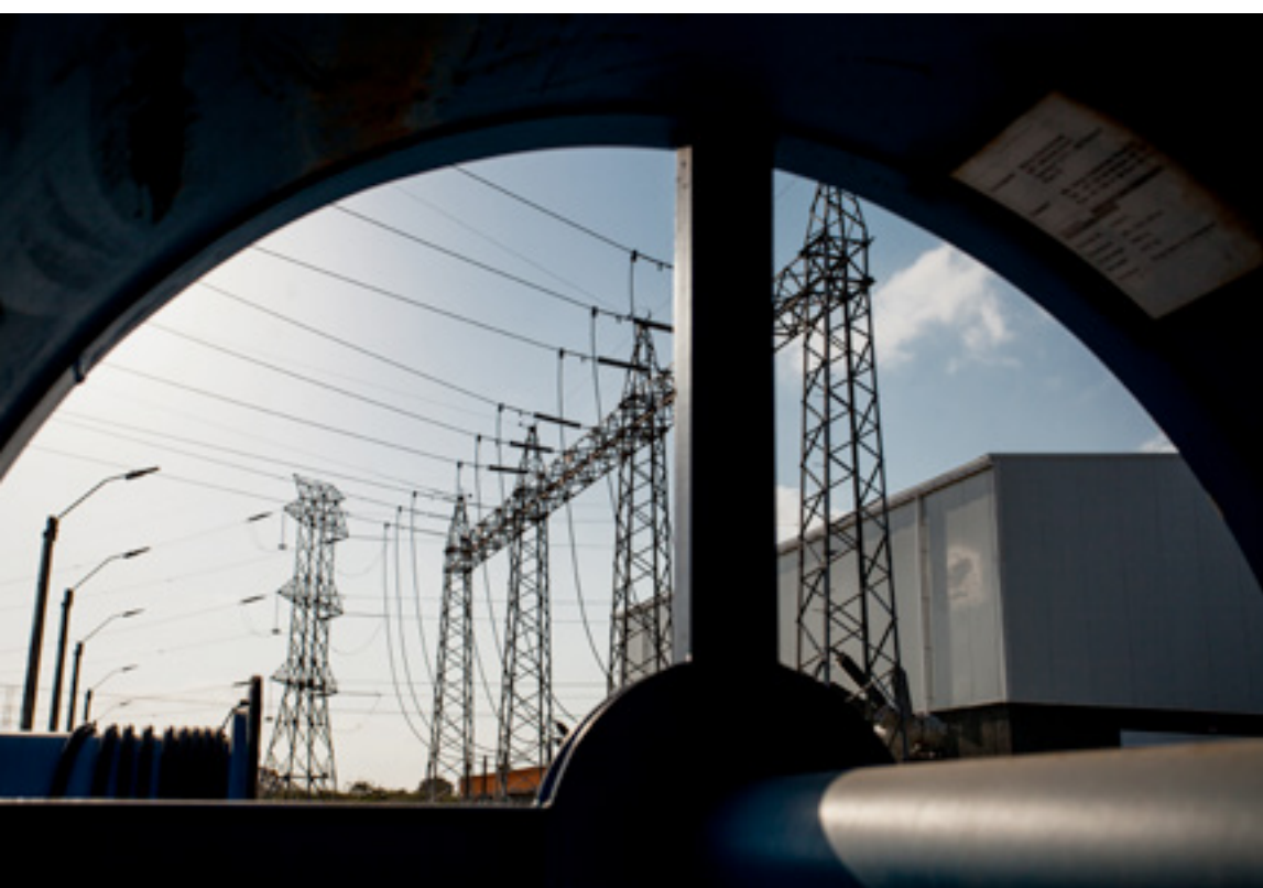
Subestación Caracol, Barranquilla, obra que hace parte del Plan5Caribe.
