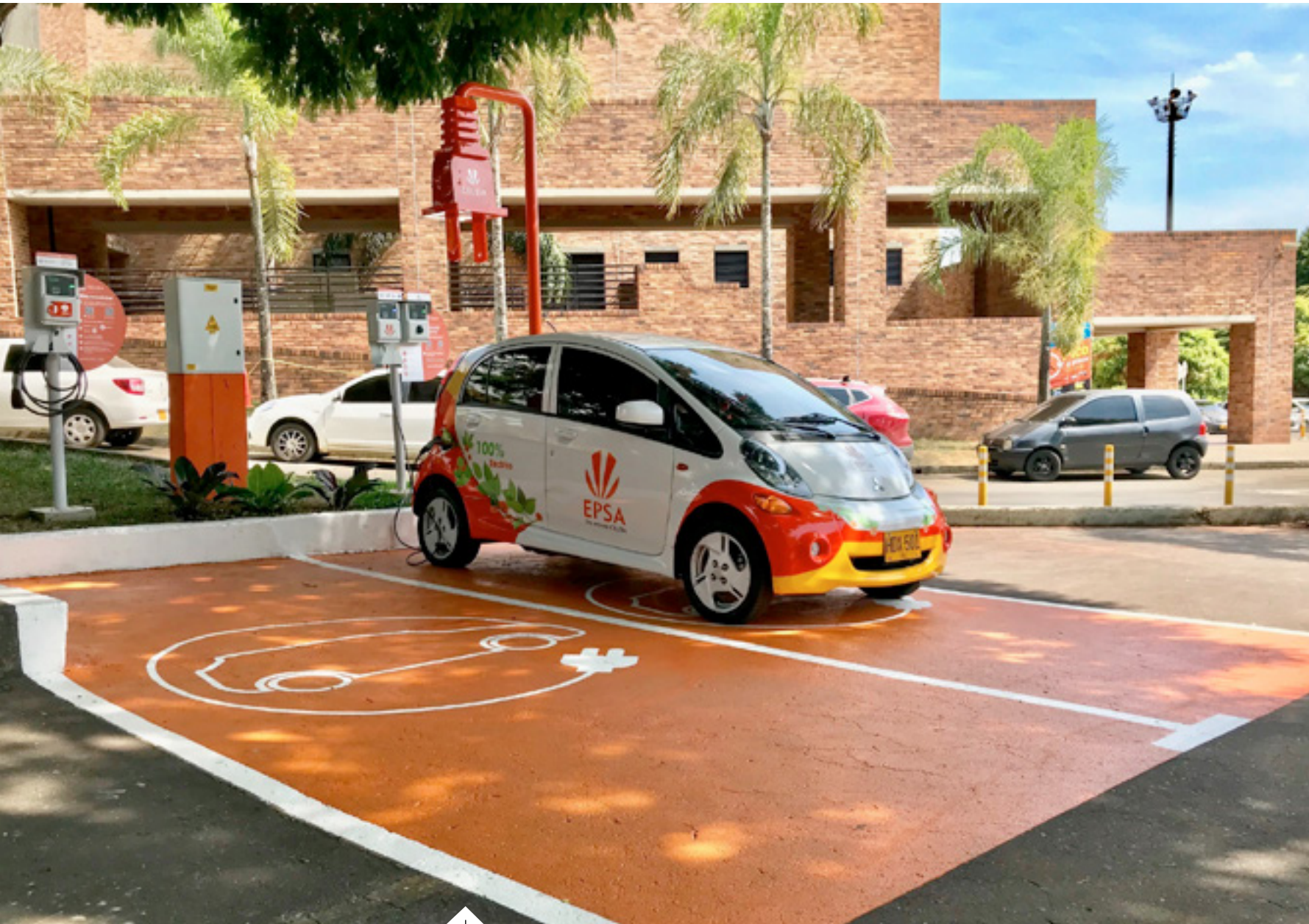
Estación de recarga eléctrica en la Universidad Javeriana de Cali. Valle del Cauca.
