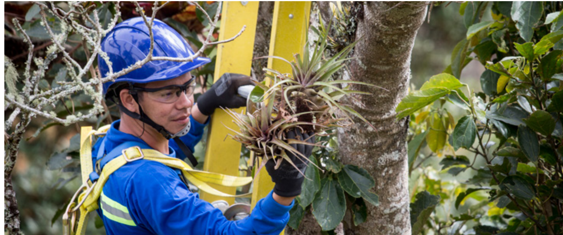
En la construcción de la pequeña central hidroeléctrica San Andrés de Cuerquia (Antioquia, Colombia), realizamos el rescate y la reubicación de orquídeas, bromelias y helechos.
