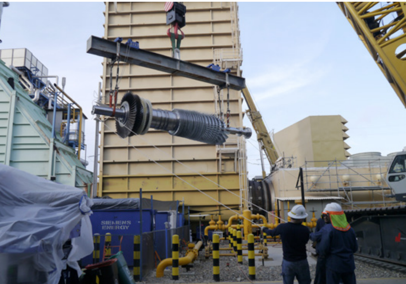
El mantenimiento realizado en la Central térmica Zona Franca Celsia optimiza la generación de energía e incrementa la eficiencia y la potencia del generador.
