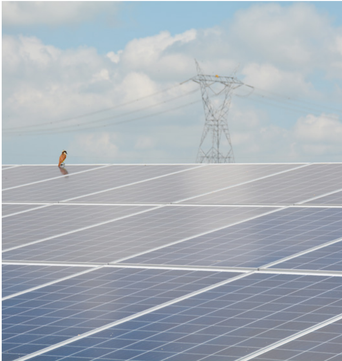
Celsia Solar Bolívar, la primera planta fotovoltaica del Caribe colombiano.
