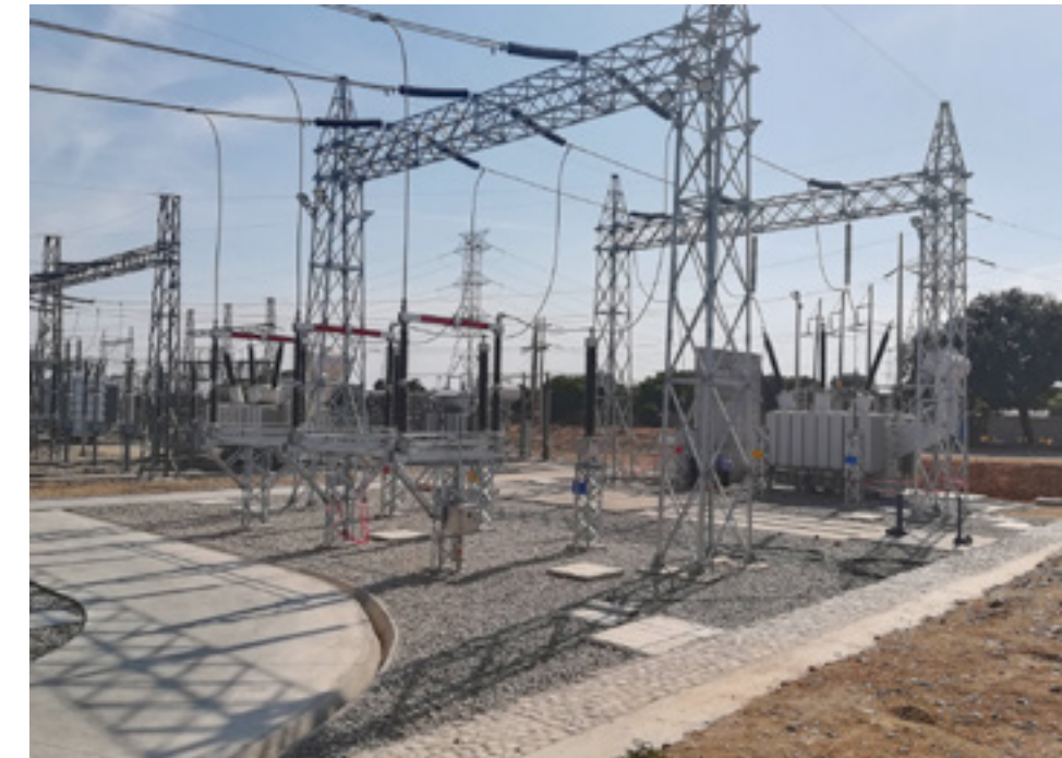
Subestación Valledupar, en el Cesar. Obra que hace parte del Plan5Caribe.
