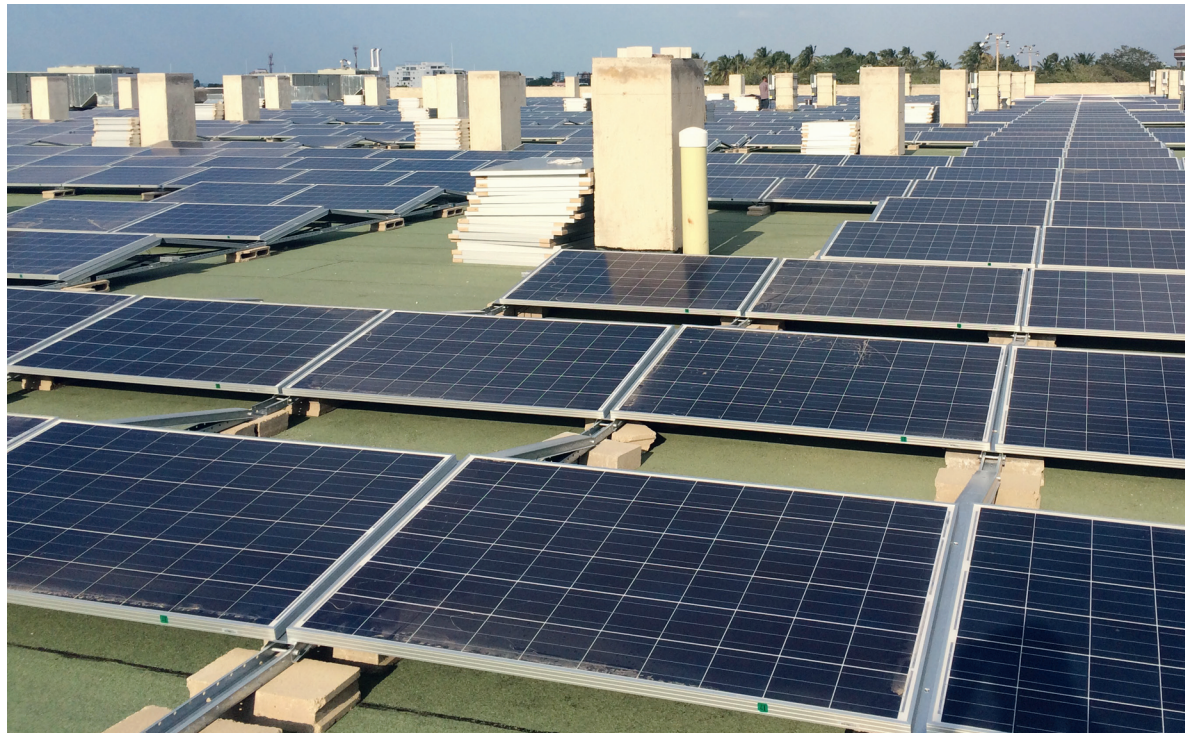
|| Planta fotovoltaica de Éxito Panorama en Barranquilla, cuenta con 2.070 paneles de energía solar.
