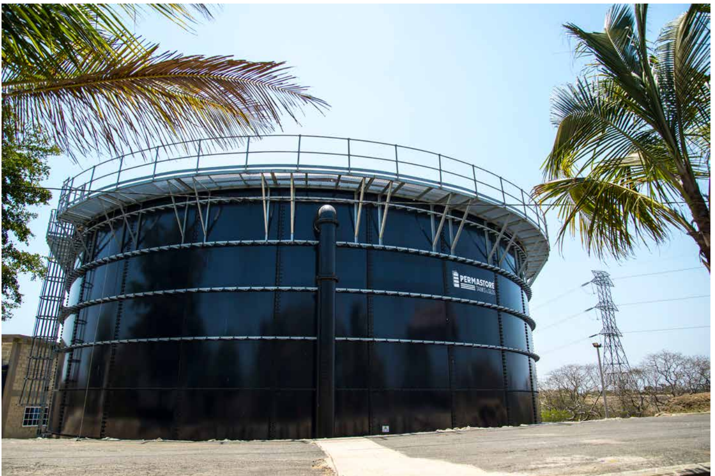
El tanque regional para la zona del acueducto costero es una obra que abastece alrededor de 45 mil habitantes de los municipios de Tubará, Juan de Acosta, Piojó y Usiacurí.
